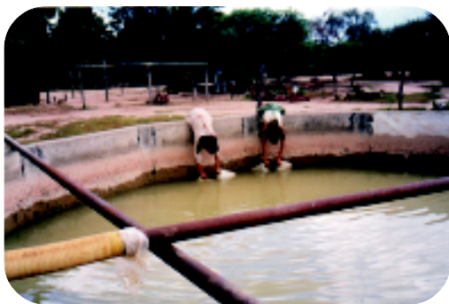
Tanque australiano de la planta potabilizadora de Tres Pozos. Al inicio del Proyecto Piloto esta planta no funcionaba. En la actualidad ha vuelto a funcionar, reparada por el APA, a pedido de los propios beneficiarios.
