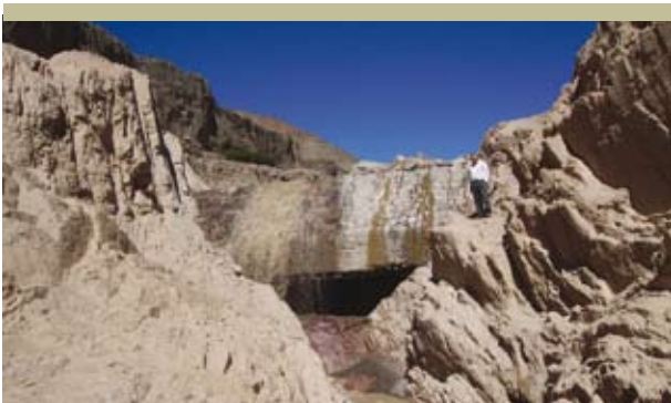
Excavación aguas abajo del punto fijo del río Colanzulí luego de la crecida del año 2006
