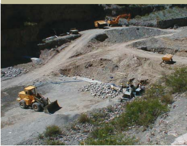
Construcción de muros transversales en el cauce del río Colanzulí, Iruya, provincia de Salta, Argentina
