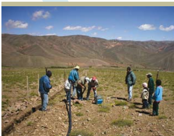
Fusión y colocación de cañerías en Campo Tapial, Iruya, provincia de Salta, Argentina
