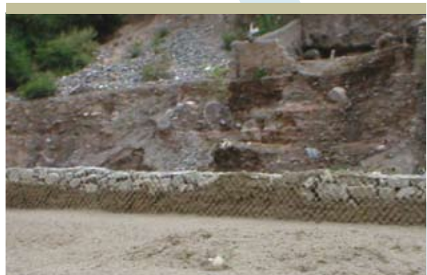
Defensas marginales sobre el río Colanzulí luego de una crecida y torrente de barro. Año 2005
