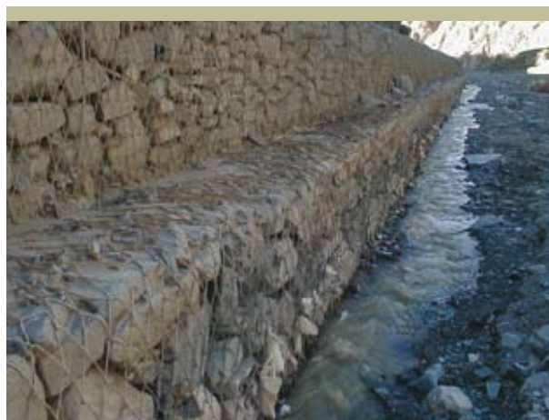
Defensa marginal de gaviones en el río Colanzulí, Iruya, provincia de Salta, Argentina
