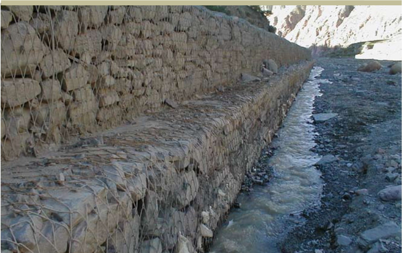
Protección de márgenes con gaviones
