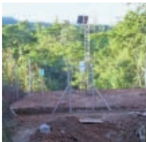
Cerca perimetral, antena, pluviómetro y datalogger en la estación San Telmo, Bolivia
