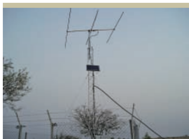
Detalle de antena de transmisión y panel solar en la estación Puerto Lavalle, Argentina
