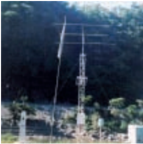
Antena de transmisión estación Balapuca, Bolivia
